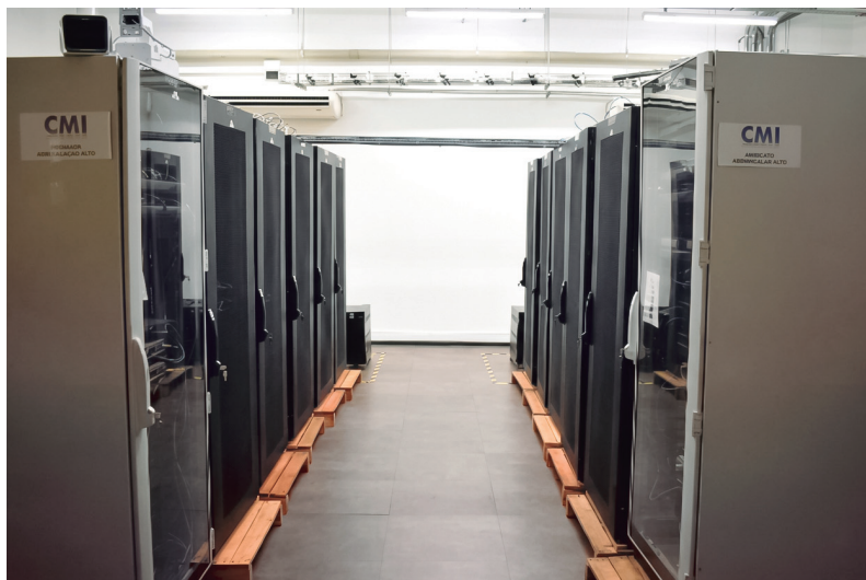
Equipamentos da RTA instalados no CINTESC
