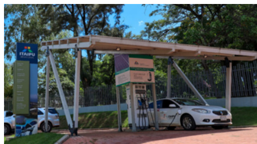
Estação de recarga em operação
