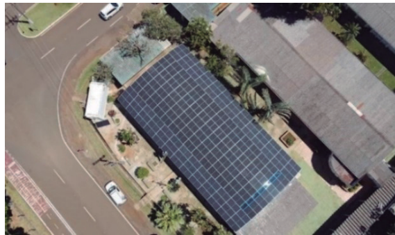
Sistema autônomo de geração solar
