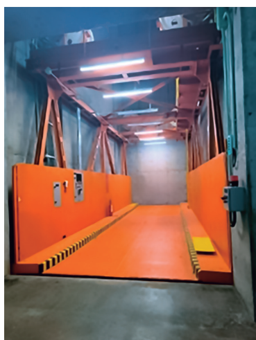
Monta-cargas localizado na AMD
