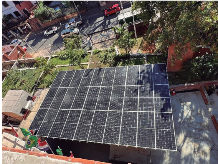
Telhados solares fotovoltaicos com injeção direta do prédio corporativo da ITAIPU Binacional
