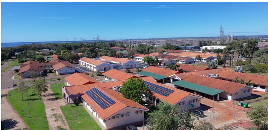
Sistema de geração solar sobre telhados
