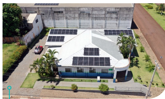
Sistema de Geração Fotovoltaica instalado em Boa Vista da Aparecida – PR
