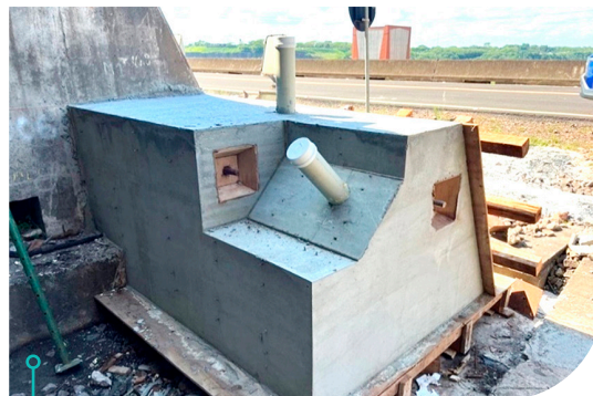
Bloco de extensômetros
