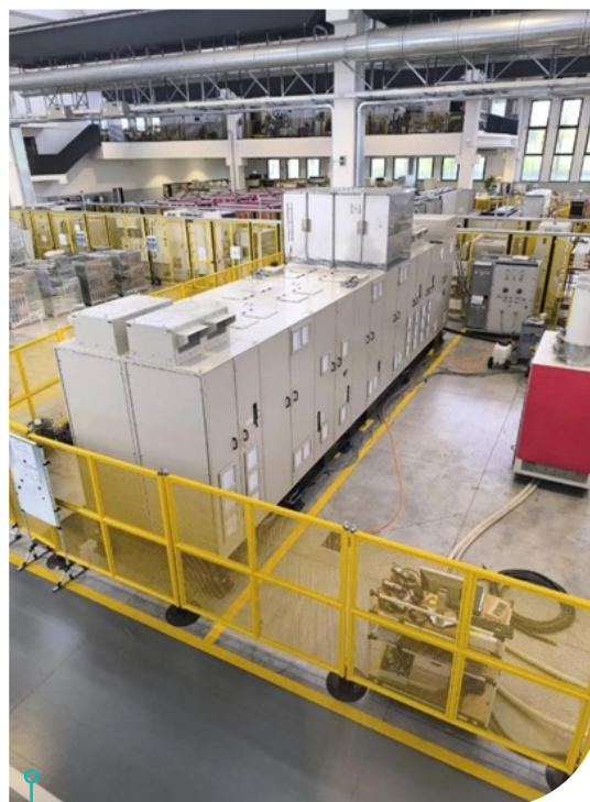
Conversor de frequência estático montado em ambiente de testes instalado na sede do fabricante em Milão, Itália
