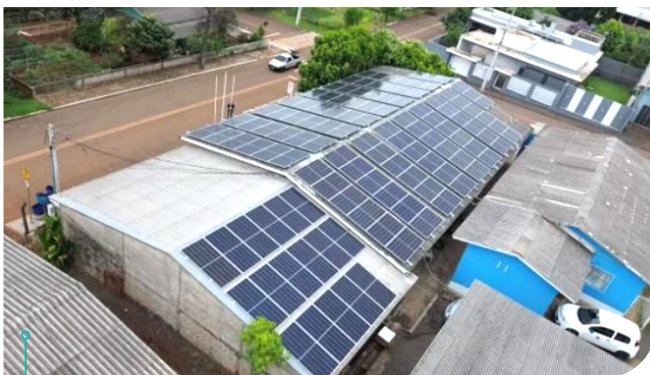
Sistema de Geração Fotovoltaica instalado em Bela Vista da Caroba – PR
