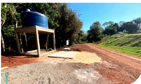
Abastecedouro comunitário instalado em Marechal Cândido Rondon – PR
