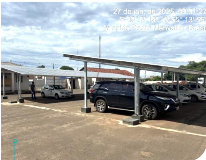
Sistema de Geração Fotovoltaica instalado em Amambaí – MS
