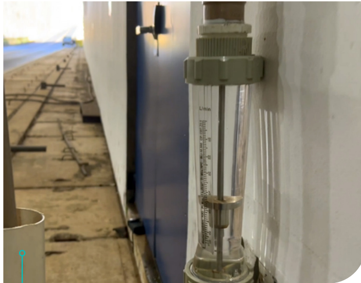
Dispositivo para os medidores de vazão
