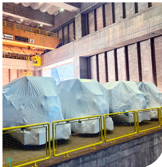
Geradores diesel de emergência
