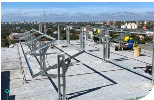
Estrutura para painéis monofaciais
