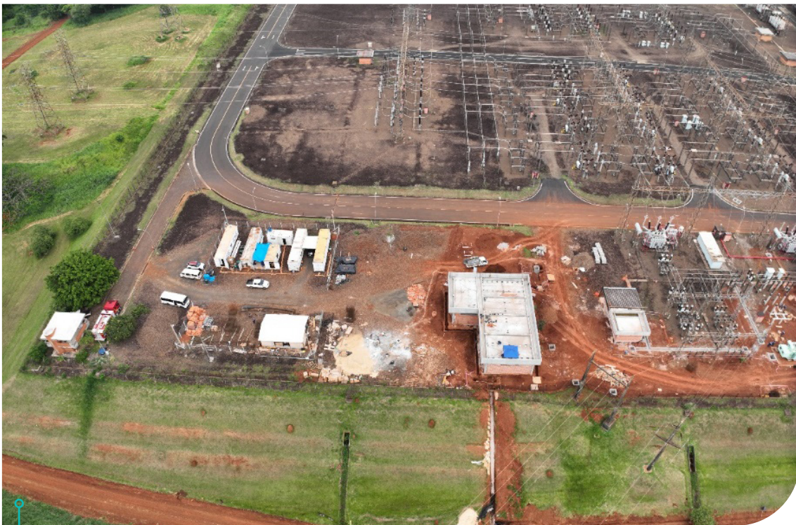
Pátio SEMD de 66 kV
